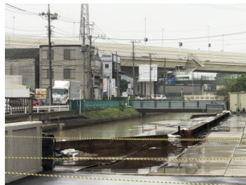
▲ 笹目南町さくら川溢水箇所
